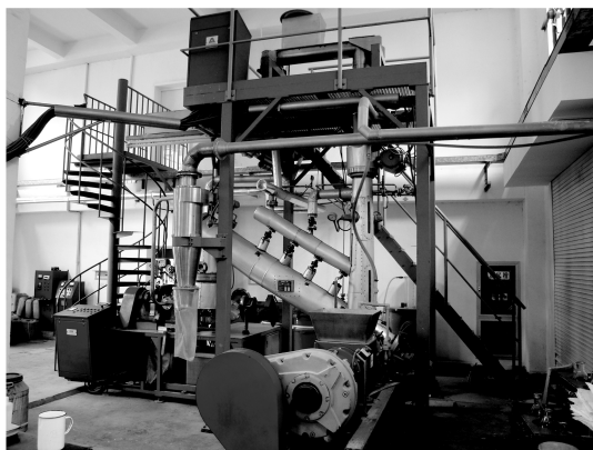
图 3-33 奥地利进口的化机浆中试线
